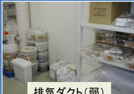
排気ダクト(弱)
