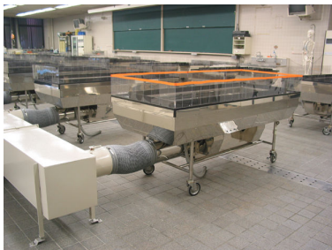
局所排気装置の各実習台への設置
