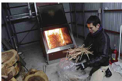
養鰻用木質ボイラ
