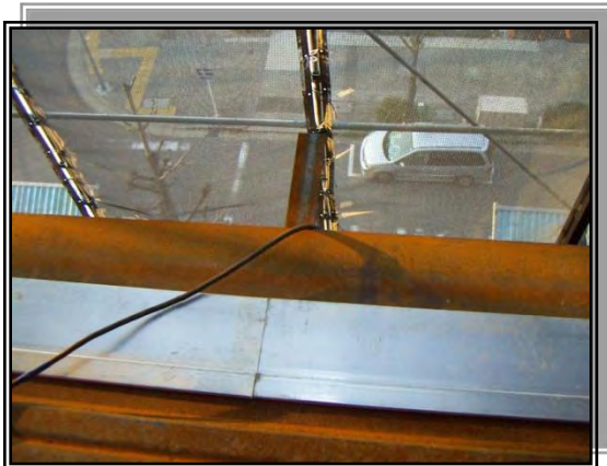
【墜落した足場の端】
