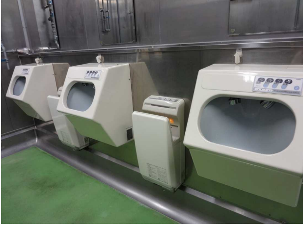
自動手洗設備
