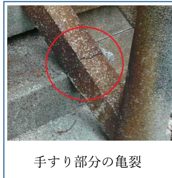
ひび割れ部分の拡大
