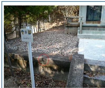
土台部の亀裂
