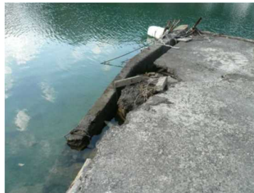
患者栈橋石積み破損箇所
