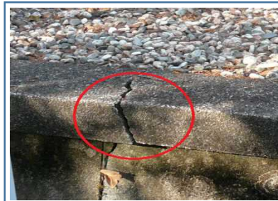
亀裂部分拡大
