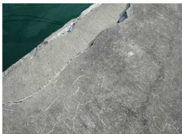
職員栈橋破損箇所
