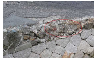
破損箇所 (横側)
