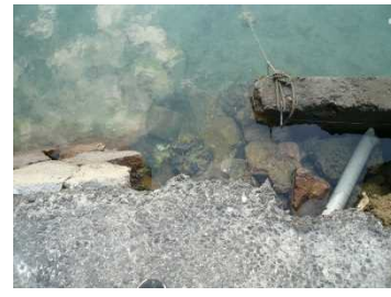
石積み破損箇所（拡大）
