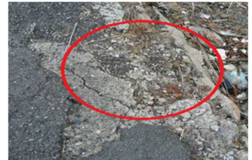
破損箇所 (上面)
