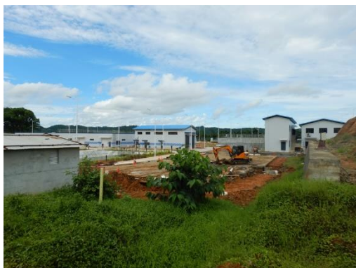
浄水施設全景
