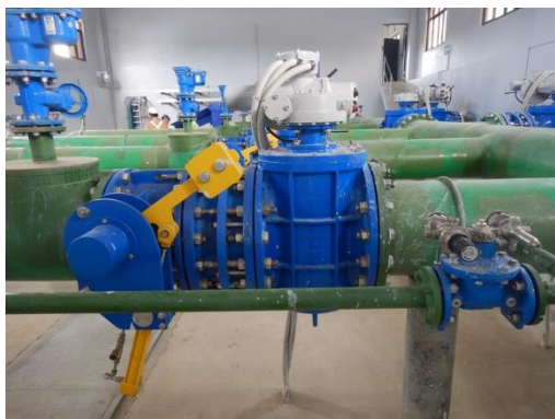
取水ポンプの流量計とバルブ
