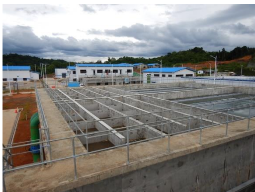
凝集沈殿池①
