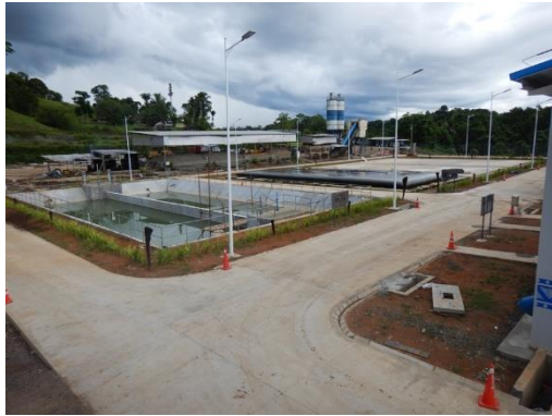
汚泥ラグーンと袋式スラッジ貯留
