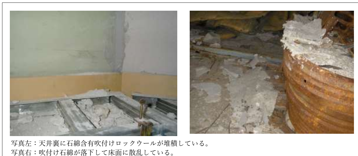
図 3.16 事前調査で把握すべき吹付け石綿等の劣化状況
