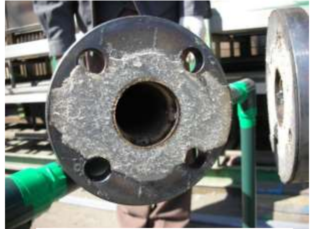
劣化して固着しているガスケット
