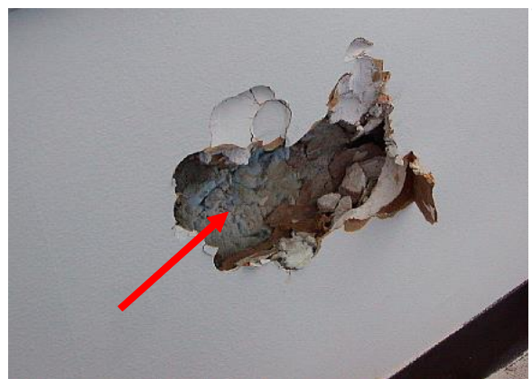
上図矢印位置の腰壁を破壊開放。ウレタン吹付けあり(不採取)
