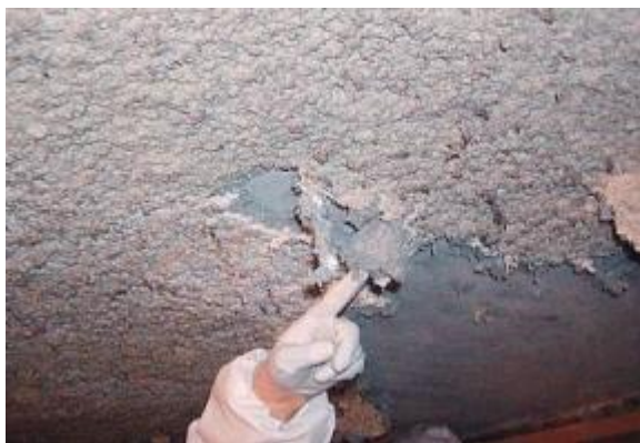
RC造スラブの天井 吹付け石綿は2層になっている
