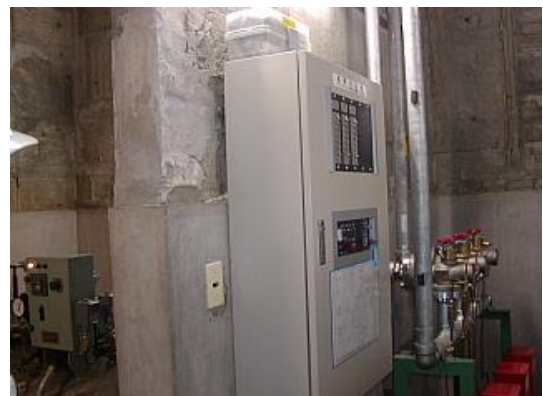
石綿除去工事が完了し、塗装されたが、分電盤の裏に吹付け石綿が取り残されている
