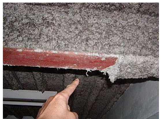
(劣化) 吹き放し工法であり、セメントスラリーもなく脱落箇所がある。
