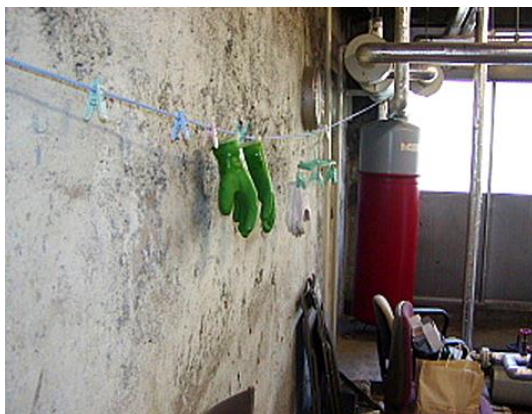
(劣化) 深い傷が多面に相当数見受けられる。
