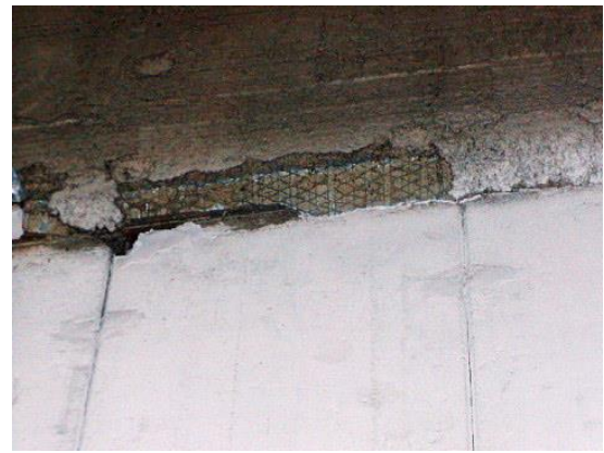
(劣化) 壁・天井取り合い部。ラス下地の暴れに伴う脱落
