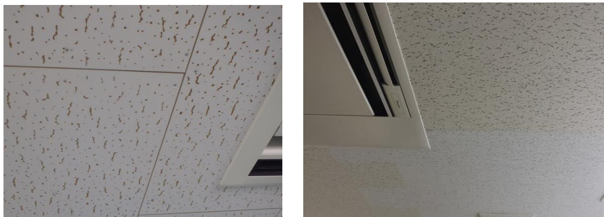
写真左：化粧せっこうボード（通称として使用される商品名：ジプトーン）の施工例。軽天にビス止めしており、継ぎ目が見える。
