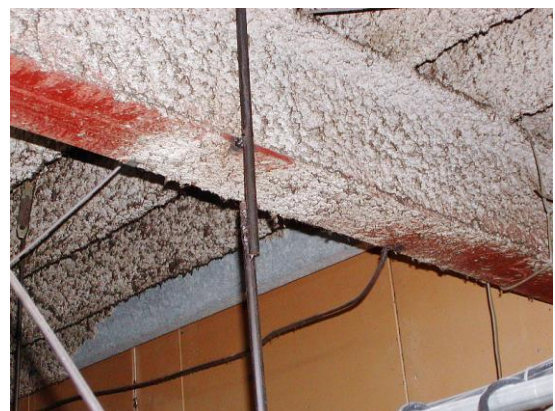
(劣化) 吹き放し工法である。また初期の吹付けロックウールがなくなっている。
