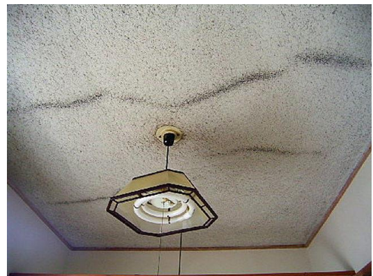
(やや劣化) 面的な状態はよいが、振動などによる筋状の呼吸作用の痕が見られる。
