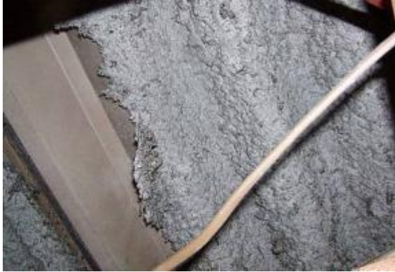
折板屋根の吹付け石綿の層状界面はく離
