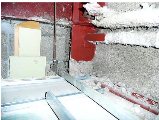
(劣化) 柱と小ばりの取り合い部。変位追従されずに脱落
