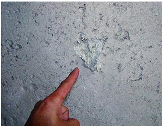
(やや劣化) 大きな損傷が複数箇所あり、その周辺の繊維に垂れ下がりが見られる。
