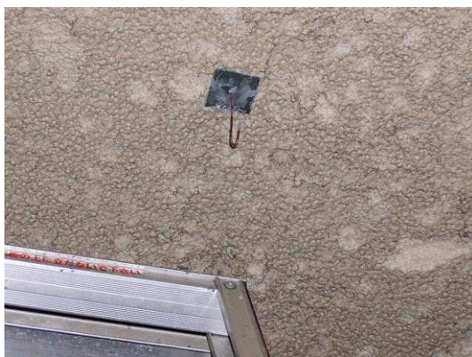
(劣化) 天井面全域に多数の損傷があり、一部では脱落し下地が見えている。
