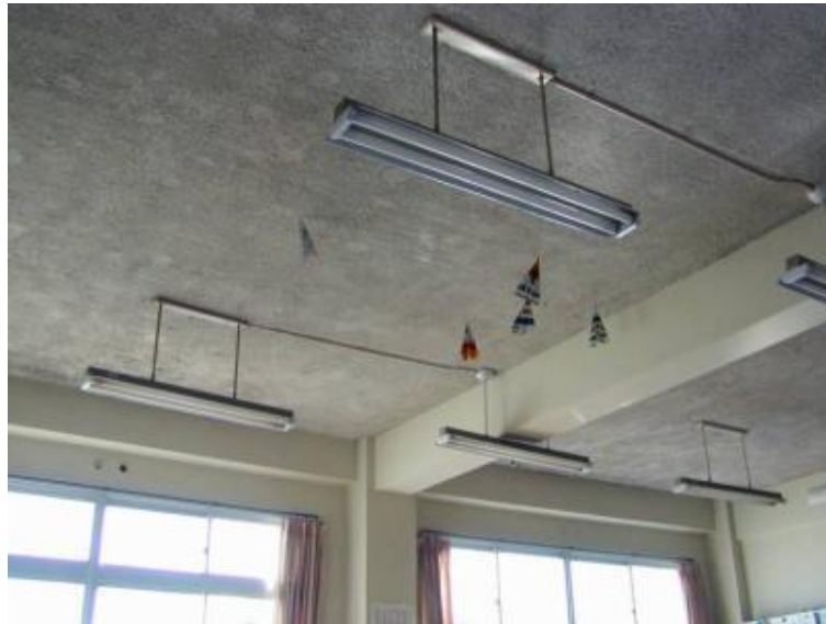
図 3.23 天井に人為的な損傷例（写真は吹付け石綿のみに起こりえる事象で吹付けロックウールではこの紙飛行機がささることはない）
