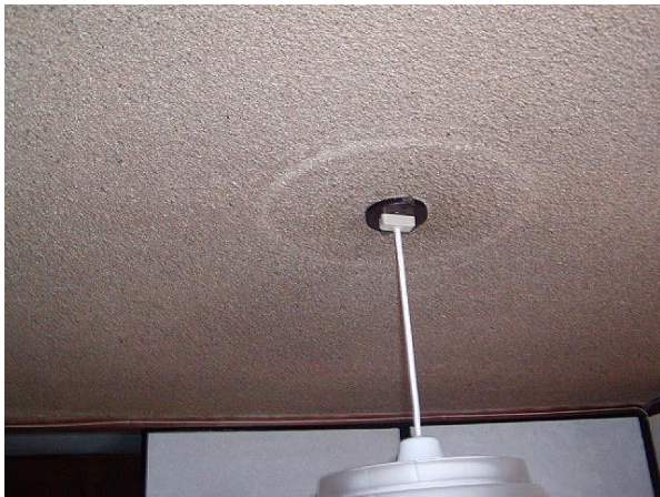
(やや劣化) 共同住宅 天井の吹付けパーミキュライト 旧照明用の大きな痕跡があり補修されていない。他の箇所は劣化なし。
