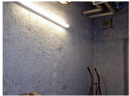
(やや劣化) 全体的な状態はよいが、人為的な損傷が多面にある。
