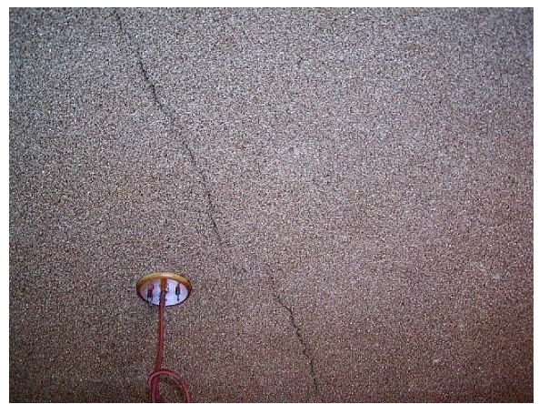
(やや劣化) RC建築物の天井のクラック。吹付けパーミキュライトは劣化無しだが躯体が不健全。追従してしまう。
