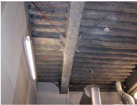
(やや劣化) 折板屋根に吹き付けされ、結露などによる色ムラが生じている。
