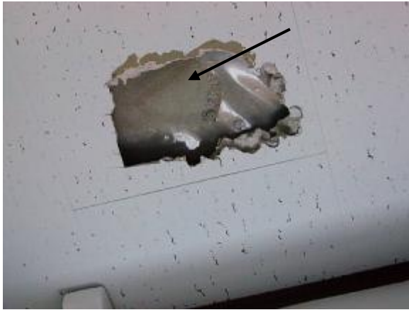
商業ビル 天井石膏ボード裏の吹付けRW ビニールで被膜されている
