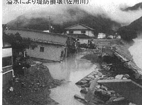
溢水により堤防損壊(佐用川)
